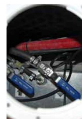
Avstängningskranar för bränslet är lättåtkomliga. I mitten ses värmarens sugledning med filter.
